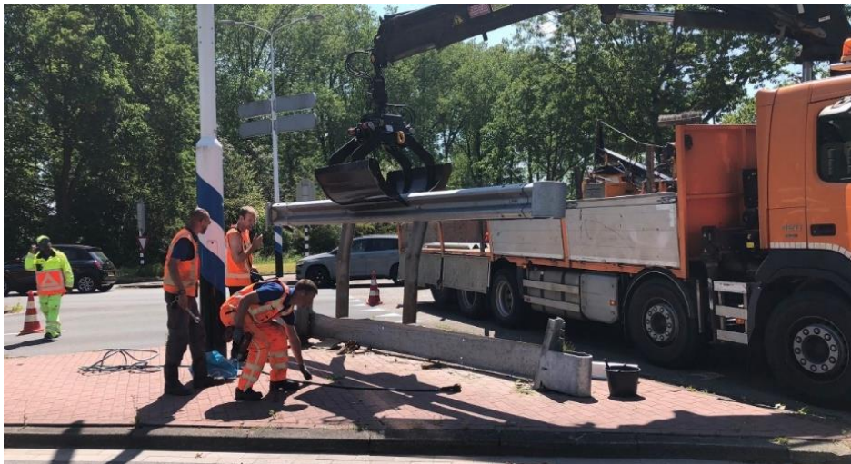
Figuur 5 Verwijderen van een aangereden vangrail.
