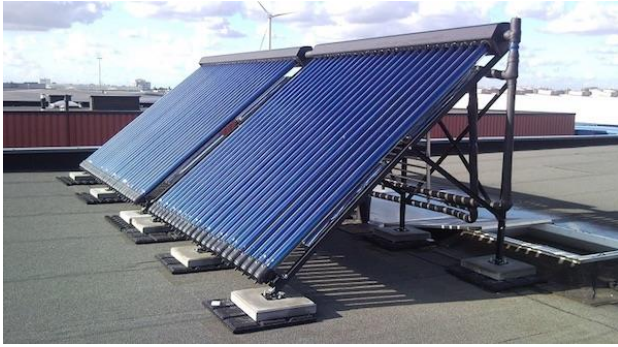
Figuur 5.4 – Voorbeeld van een zonnecollector (l) en een PVT-paneel (r)
