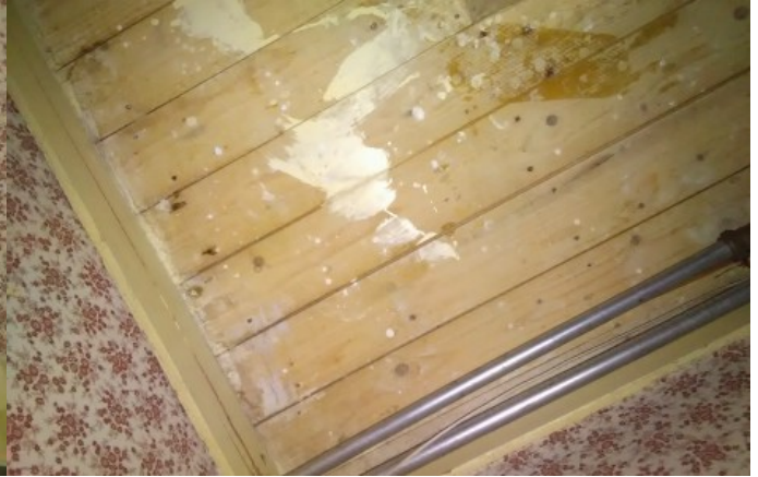
toelichting foto: plaats waar is gesaneerd
