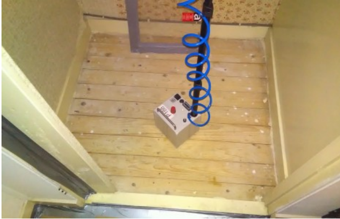
toelichting foto: pompstelling
