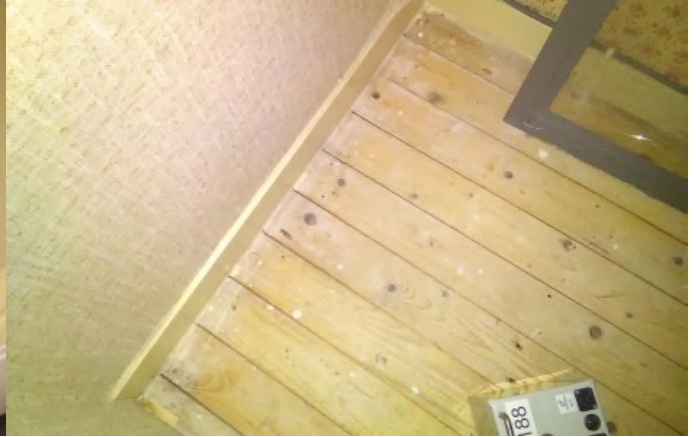
toelichting foto: plaats waar is gesaneerd
