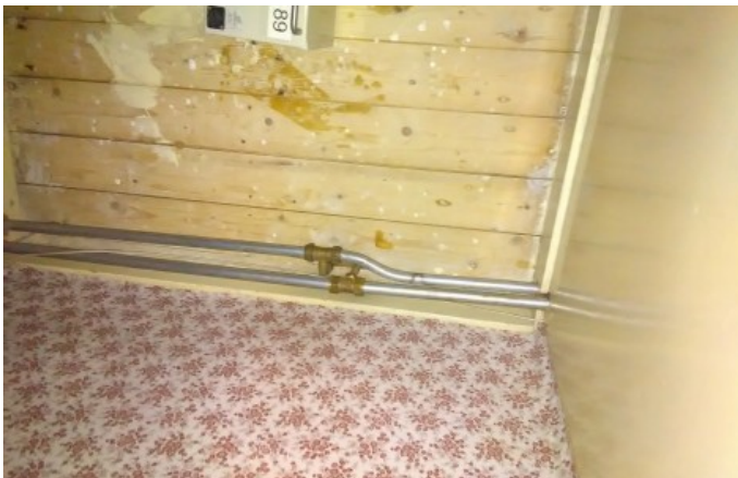
toelichting foto: plaats waar is gesaneerd
