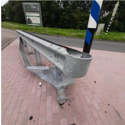
Figuur 2 Geleiderail waarbij aanrijdingschade zichtbaar is.
